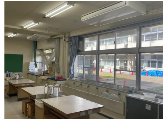
理科室に設置されたエアコンのようす ↑
