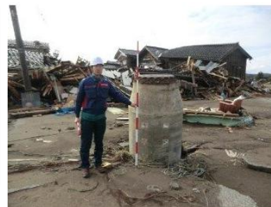
人孔浮上(珠洲市)
