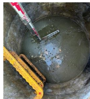
人孔内土砂閉塞(羽咋市)
