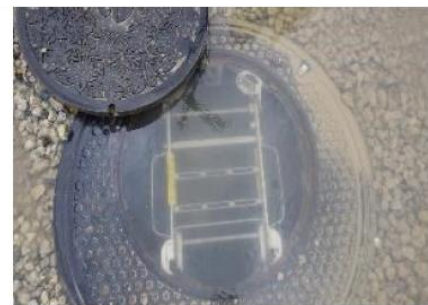
人孔内滞水(七尾市)
