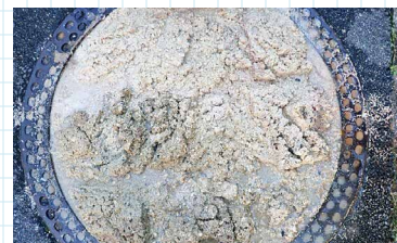
詰まってしまったマンホール
