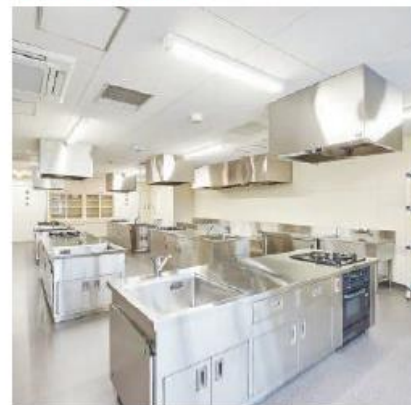
料理教室や災害時の炊き出しにも、利用できます。災害時に備え、LPガスを使用しています。
