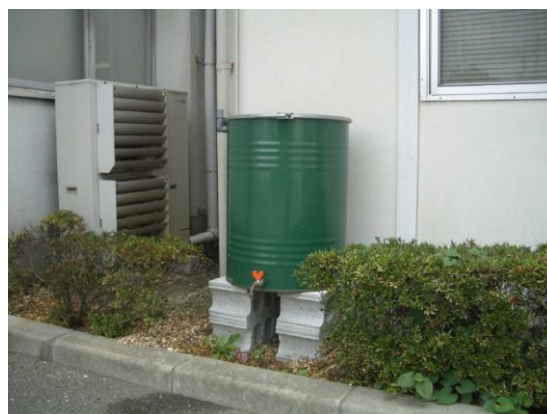
雨水タンク（市役所本館）
