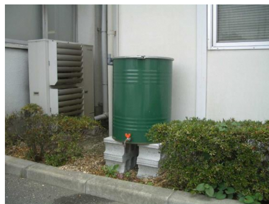
雨水タンク（市役所本館）
