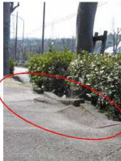
根あがりによる通行への支障
